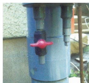
▲写真① オリフィスからは管理ボックス内の雨水を少しずつ排出する仕組みになっている
